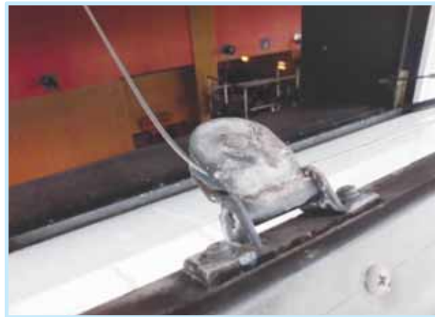
滑車の錆(回転軸が錆付き回転しない)
