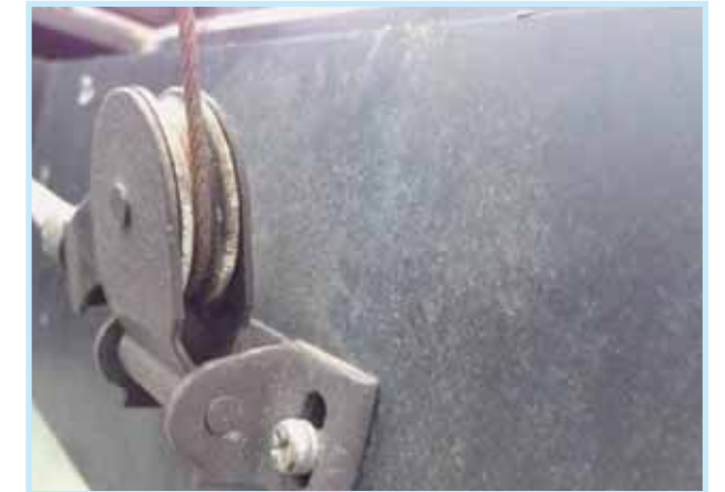
ワイヤーの錆
