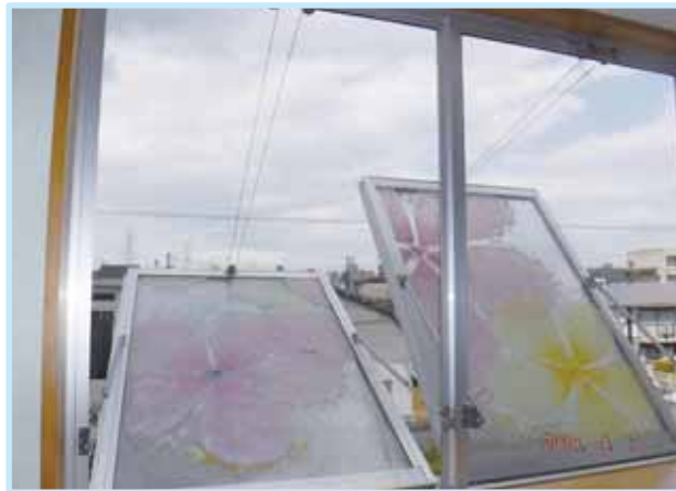
ダンパーのガス抜け(右側障子開閉不良)
