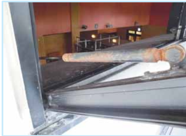
ダンパーの錆
