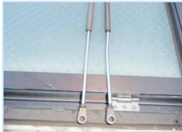
ダンパーの変形(外的要因による曲り)
